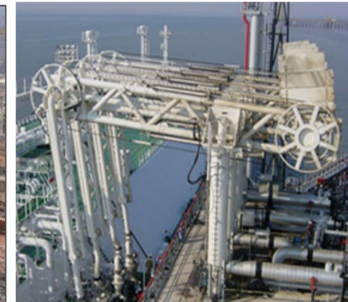
LNG Loading Arms
